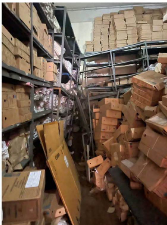
Figure 3 : Une des salles d'archives de la Cour des comptes de Madagascar au plancher affaissé Source: Cour des comptes Madagascar
