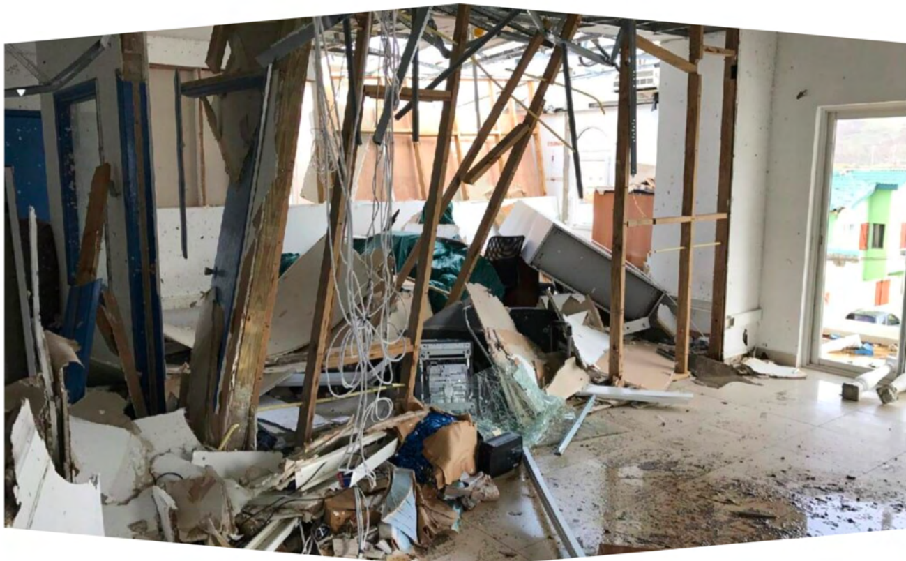
Domages causés par la tempête aux bureaux de la Cour générale des comptes, 13 septembre 2017, Source : Cour générale des comptes.
