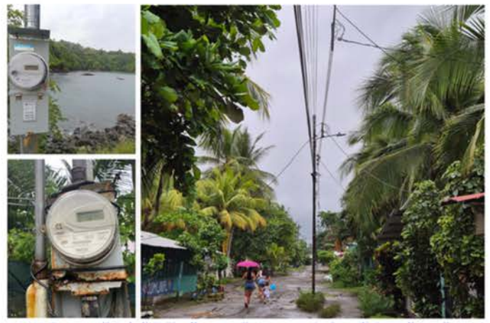
البنية التحتية للكهرباء في كيبوس. المصدر: المراقبة العامة للجمهورية
