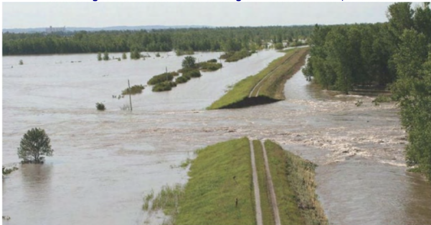
Abbildung 2: Gebrochener Deich entlang des Missouri-Flusses, Juni 2011
